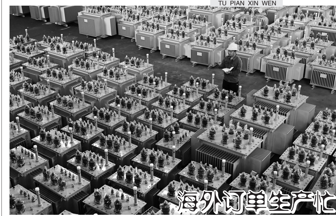
近日,在内江市德华变压器有限责任公司生产车间,技术人员在加工、检测、清点变压器设备。近年来,内江市东兴区积极引导民营企业通过技术创新和装备升级提升产品竞争力、拓展海外市场,外贸企业呈现出海外订单稳定、产销两旺的良好态势。
