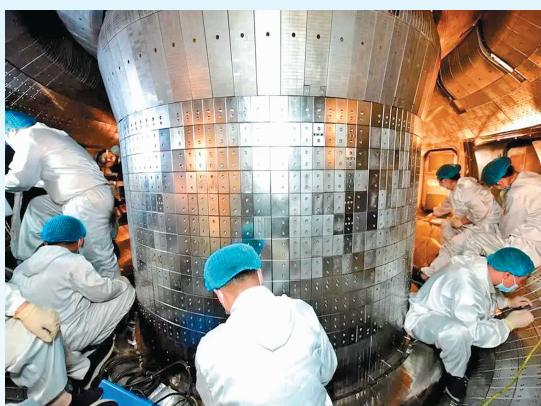
中国科学院合肥物质科学研究院，工作人员对全超导托卡马克核聚变实验装置(EAST)进行升级改造(2021 年 4 月 28 日摄)。
