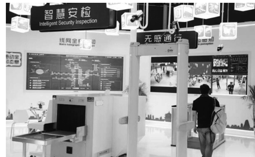
新线安检通道。成都地铁运营有限公司供图
