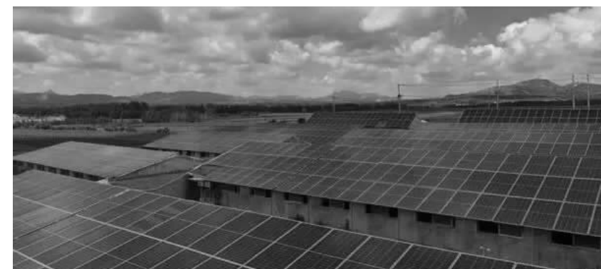
菌菇棚顶安装的光伏电板。
