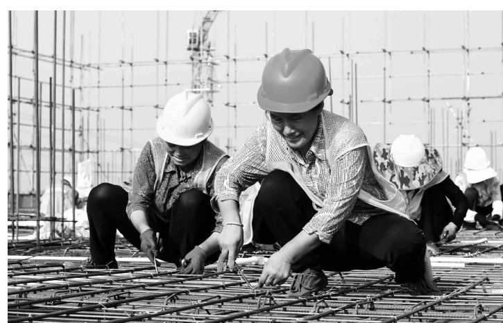
在四川仁寿经济开发区标准厂房项目建设现场,工人们加紧施工。
