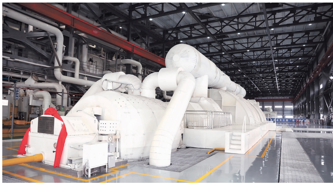
东汽改造后的德州5号700MW汽轮机
