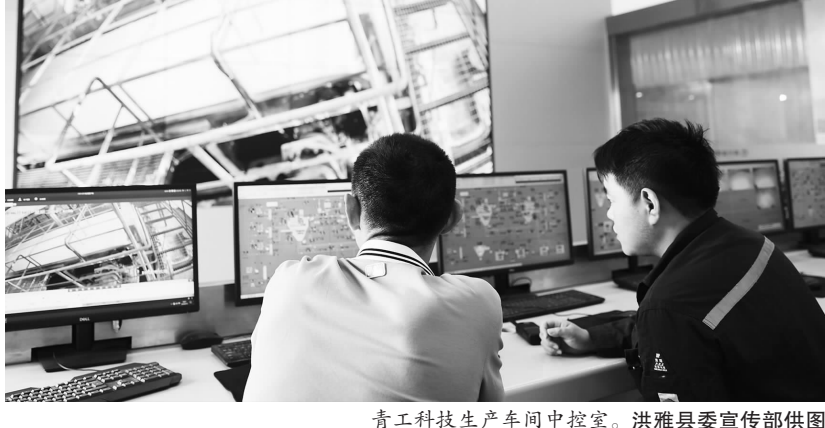
青工科技生产车间中控室。洪雅县委宣传部供图
